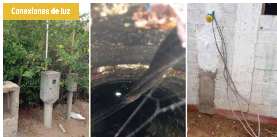
Conexión de luz sale de la Panamericana Sur, la cruza por una alcantarilla con cables sin protección y llega al CERITEM de manera artesanal.
