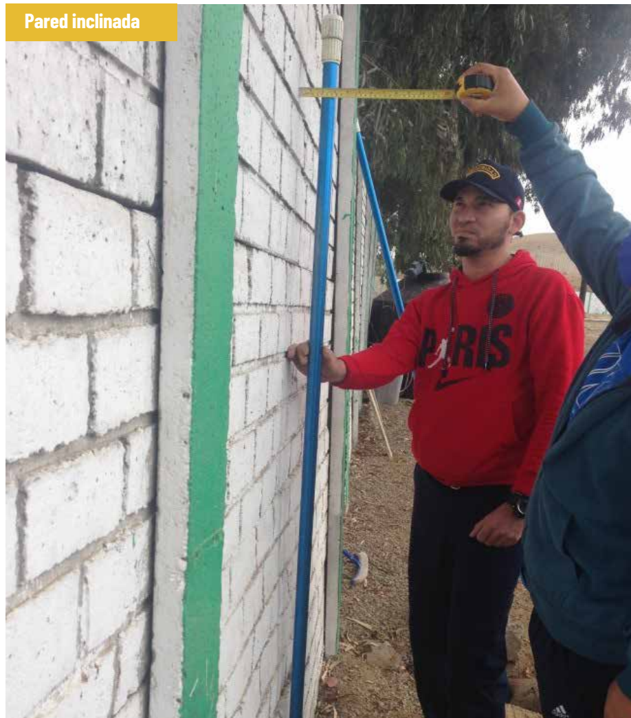
Cerco perimétrico inclinado por asentamiento del cemento.
