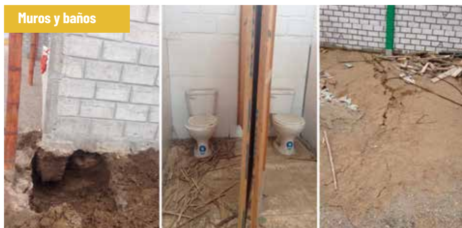
Muro construidos sin cemento, baños sin agua y piso con fallas.
